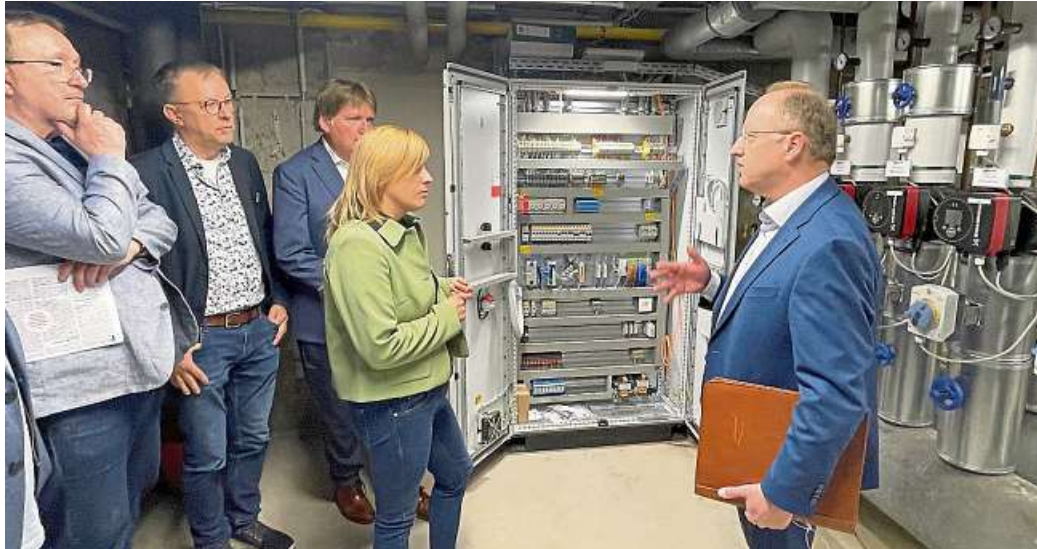
EDG-Geschäftsführer Christoph Zeiss (r.) erläutert vor dem Schaltschrank die Technik der neuen Heizungsanlage im Kulturzentrum des Landkreises in Alzey. Mit dabei sind Gerd Greis (Leiter der Kreismusikschule), Stefan Maurer (Referatsleiter Gebäudemanagement), Landrat Heiko Sippel und Kreisbeigeordnete Stephanie Jung (v.l.).
